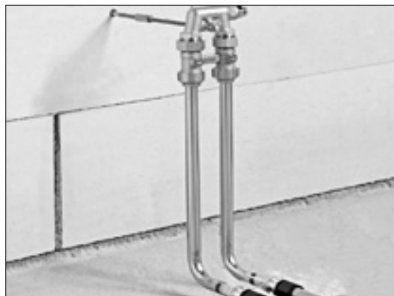
Готовый монтажный блок для подключения отопительного прибора.
